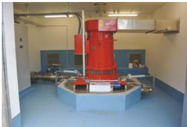
Vue intérieure du local de turbinage
