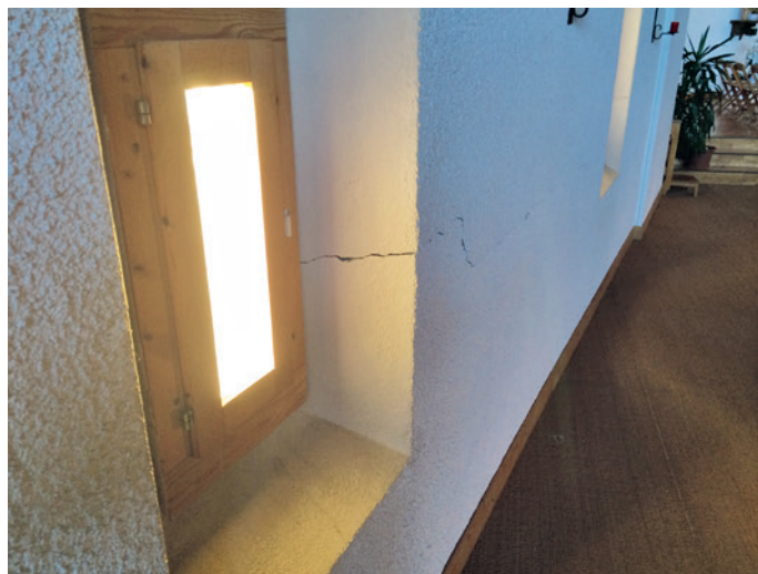
Remplacement des fenêtres simples vitrages / Fissure
