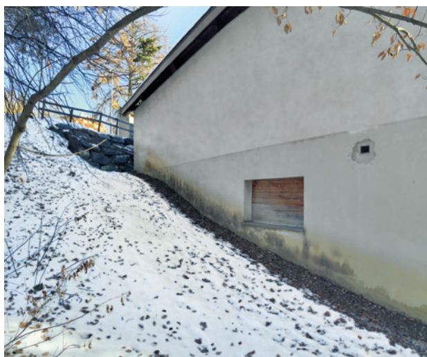
Remontées d'humidité dans les façades / Peinture
